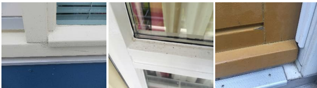
Foto 1: Lichte verschade bij verbindingen en kitvoegen
